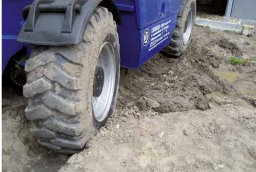
Haltlos – die Baufahrzeuge konnten nicht sicher stehen
